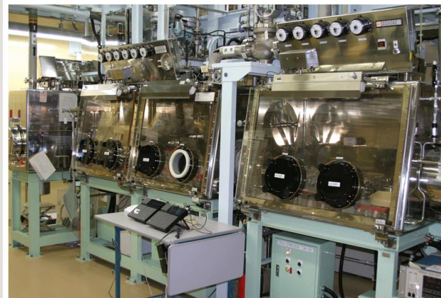
図6 アルゴン循環型グローブボックス [出典](独)日本原子力研究開発機構:パンフレット「燃料サイクル安全工学研究施設NUCEF」、 原子力科学研究所 安全試験施設管理部(2006)、p.10
