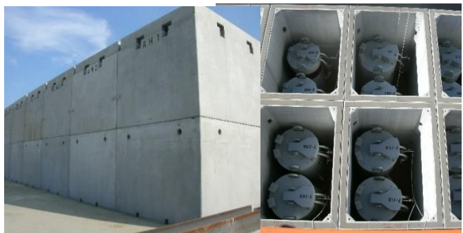
Box culvert (Cesium absorption apparatus)
